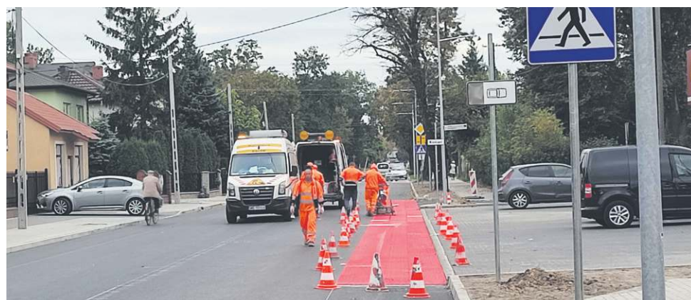
Przebudowano wjazdy na posesje, zatoczki autobusowe, zadbane o miejsca parkingowe przed sklepami
