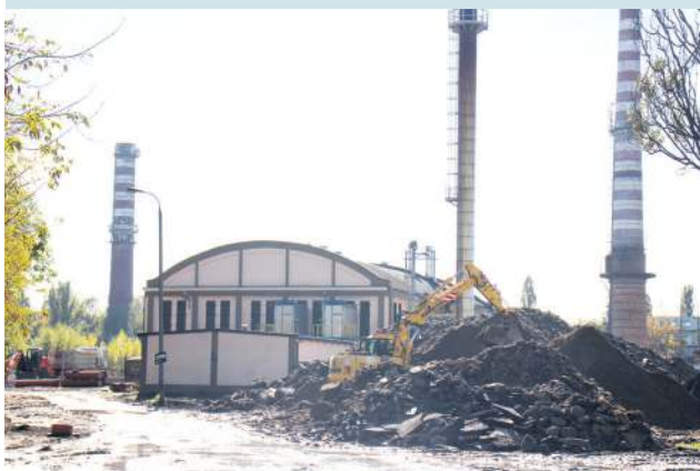
Prace na terenie Chemitexu, związane z utwardzeniem i odwodnieniem trzech ulic, rozpoczęto od zerwania starej betonowej nawierzchni
