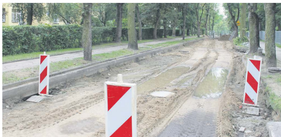
Ulicą Parkową przebiega kolektor odprowadzający wody opadowe z części Chodakowa
