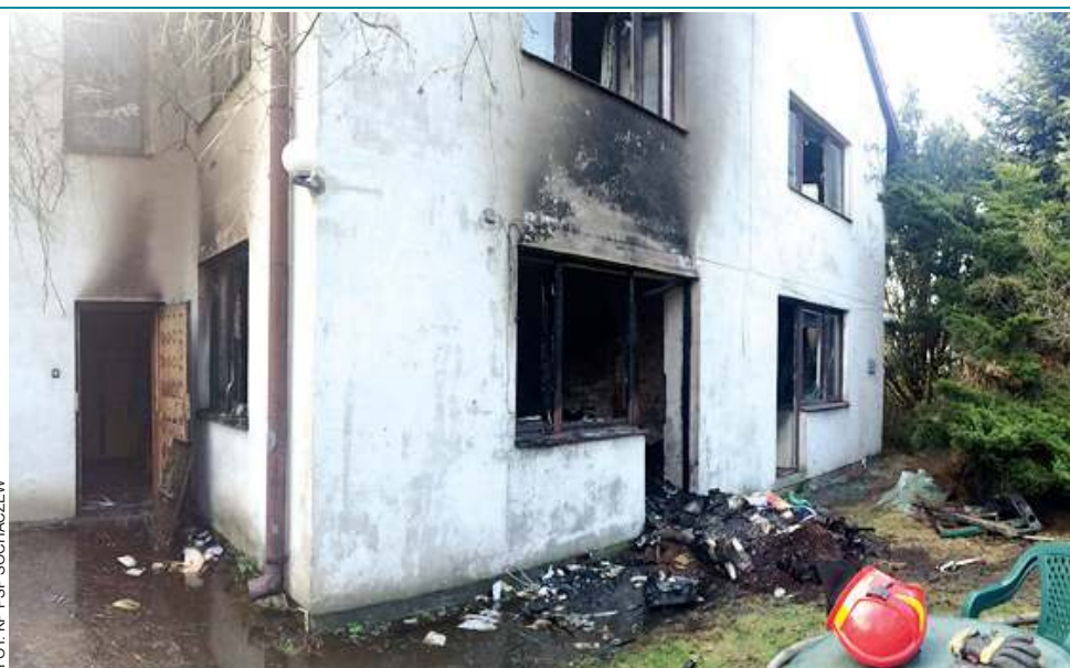
W trakcie akcji gaśniczej strażacy wydobyli z budynku ciało 68-letniego mężczyzny
