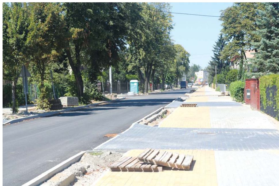
Na Licealnej położono już pierwszą warstwę asfaltu. Chodniki czekają na kosmetyczne wykończenie
