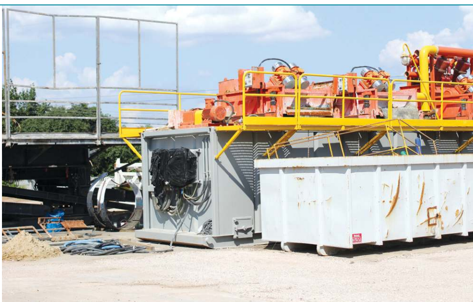
Trwa montaż wiertni, która już niebawem wbije się nieomal półtora kilometra w ziemię
