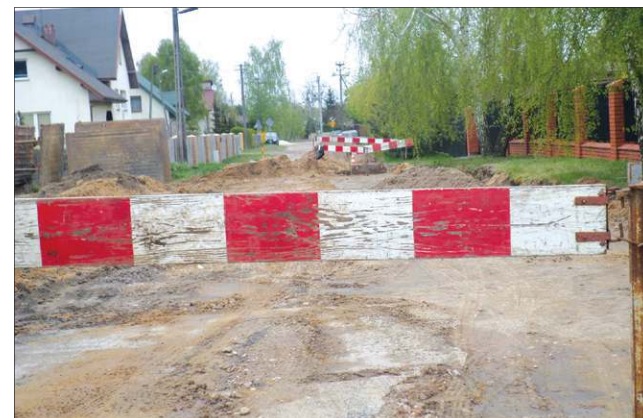
Postęp prac widać także na osiedlu Karwowo, w ulicach Tęczowej i Malinowej, gdzie 19 kwietnia rozpoczęła się budowa kanalizacji deszczowej
