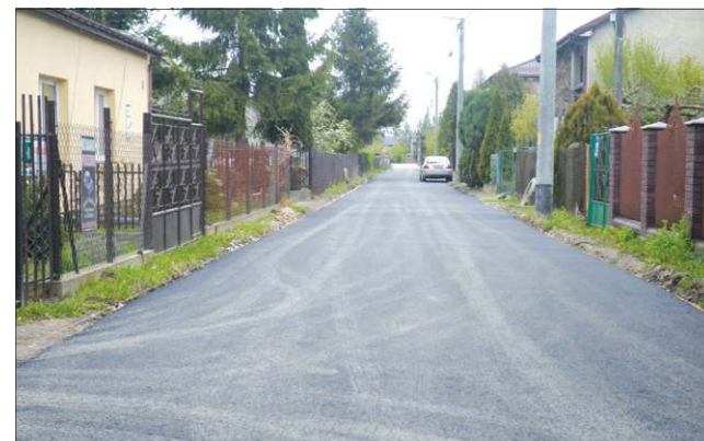
Ulica Kilińskiego, jeszcze w trakcie robót, to 260 metrów asfaltu dla mieszkańców dzielnicy Chodaków
