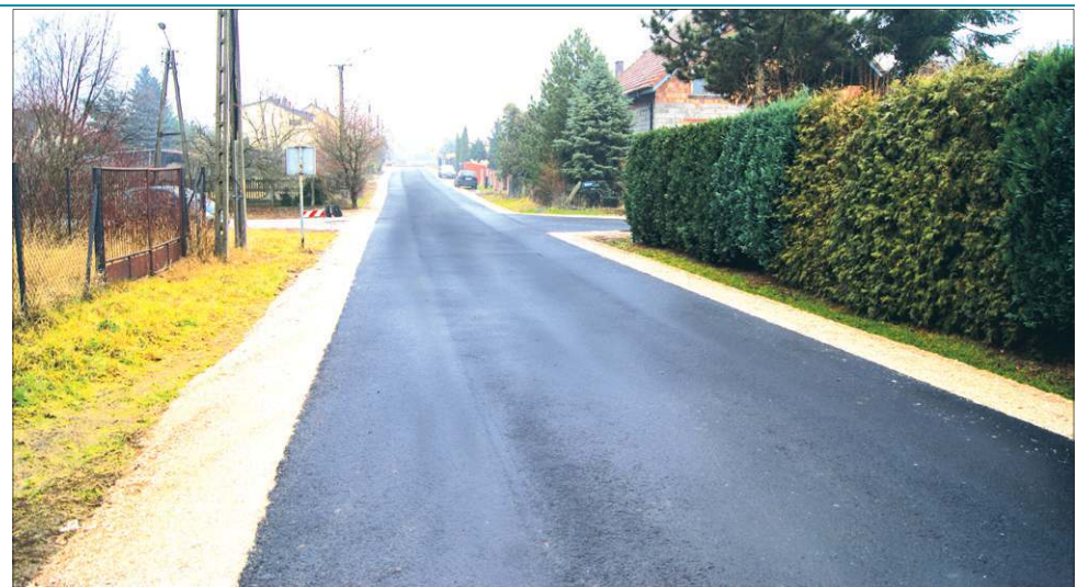
W ubiegłym roku w ramach „Drogi zamiast błota” asfalt wylano na 22 ulicach osiedlowych
