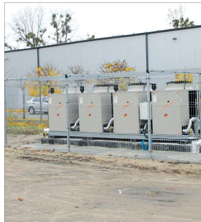
W ramach termomodernizacji uruchomiono pompy ciepła
