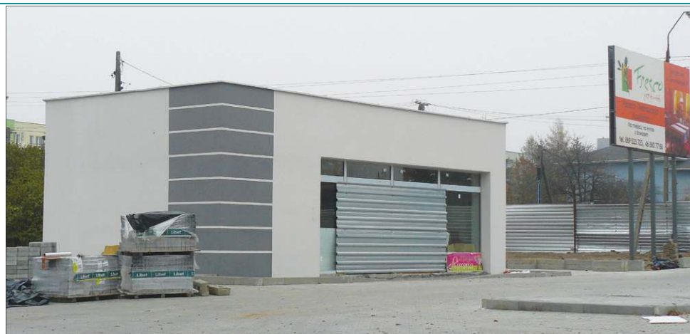
W tym momencie inwestycja sprawia wrażenie opuszczonej budowy
