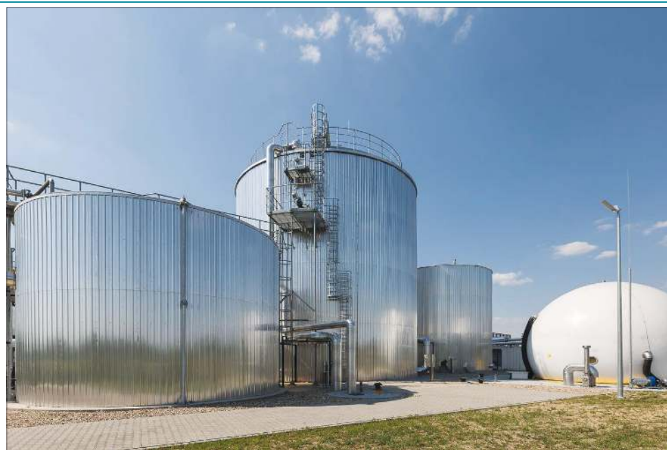
Oczyszczalnia zamienia blisko 100 proc. ścieków w energię odnawialną
