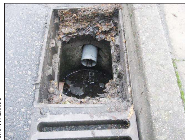
Nielegalne odprowadzenie ścieków do kanalizacji deszczowej przy ul. Modrzewiowej
