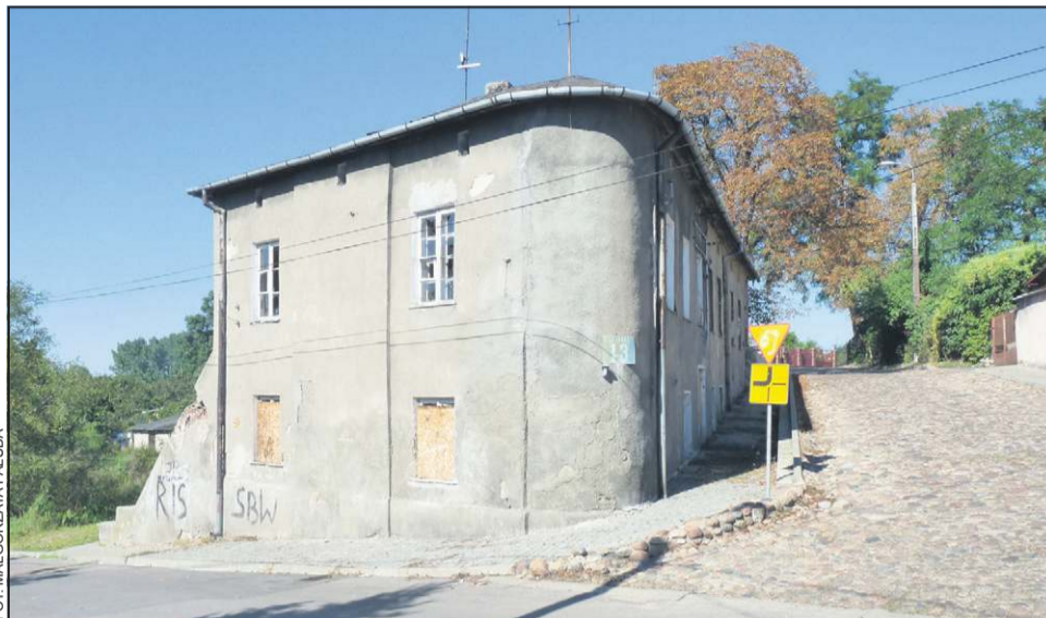
Czy mocno zniszczony zabytkowy budynek przy Farnej 13 uda się uratować?
