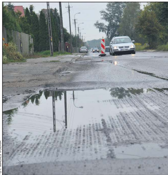
Ulica Wyszogrodzka niszczy się z każdym tygodniem. Zobowiązany do dokonania napraw wykonawca nie dotrzymał już jednego terminu
