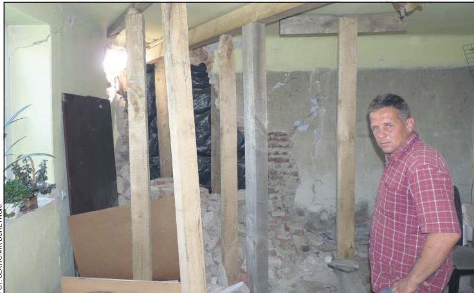
Stemple podtrzymują strop, a ściany pękają
