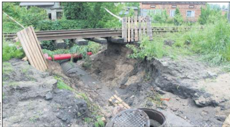
Uszkodzony nasyp kolejki w Chodakowie
