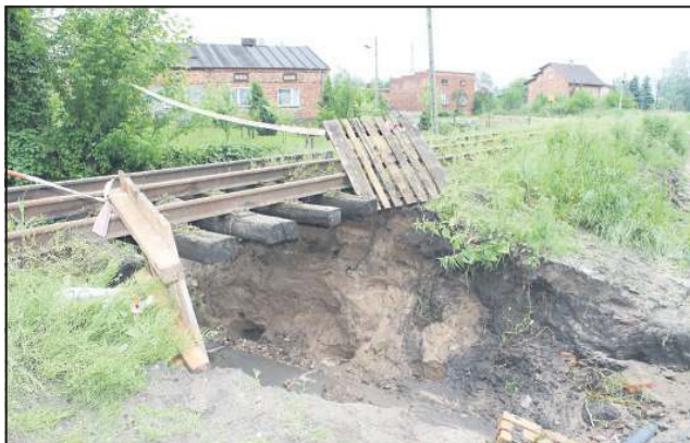
Przerwany przez wodę nasyp kolejki przy Wyszogrodzkiej
