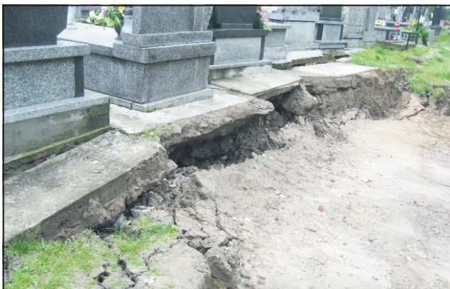
Skutki nawałnicy są opłakane. Osunięcie na cmentarzu parafialnym
