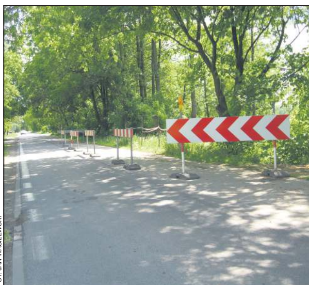
MZDW wygradził fragment jezdni grożący osunięciem
