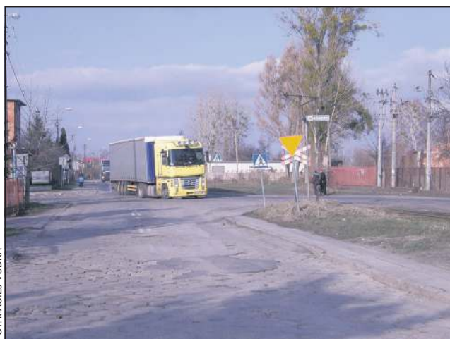
Ulica Wyszogrodzka od lat wymaga gruntownego remontu
