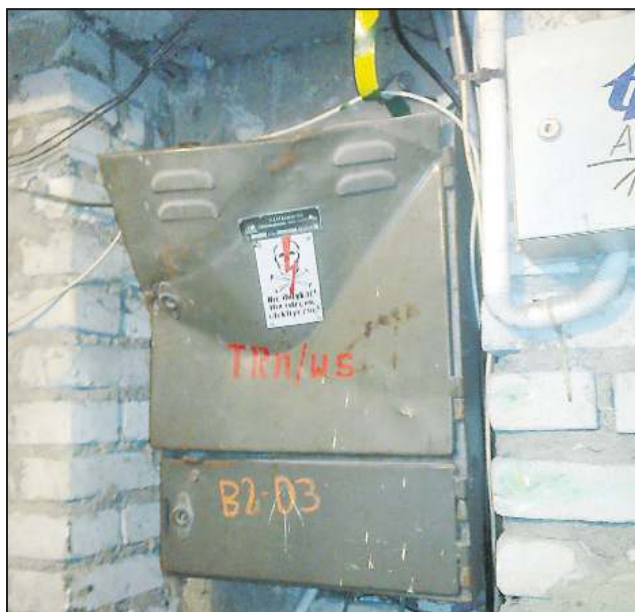
W bloku przy al. 600-lecia 25 zniszczono rozdzielnie elektryczne
