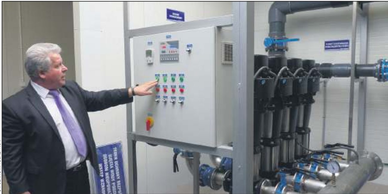
Wójt Mirosław Orliński prezentuje zalety nowoczesnej stacji uzdatniania wody
