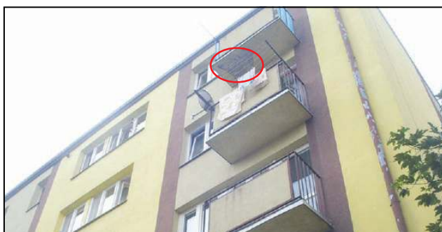
Tynk odpadający z balkonów może być bardzo niebezpieczny
