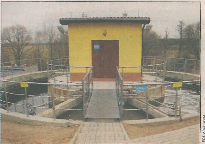
W Brochowie od miesiąca działa nowa, wydajna oczyszczalnia ścieków
