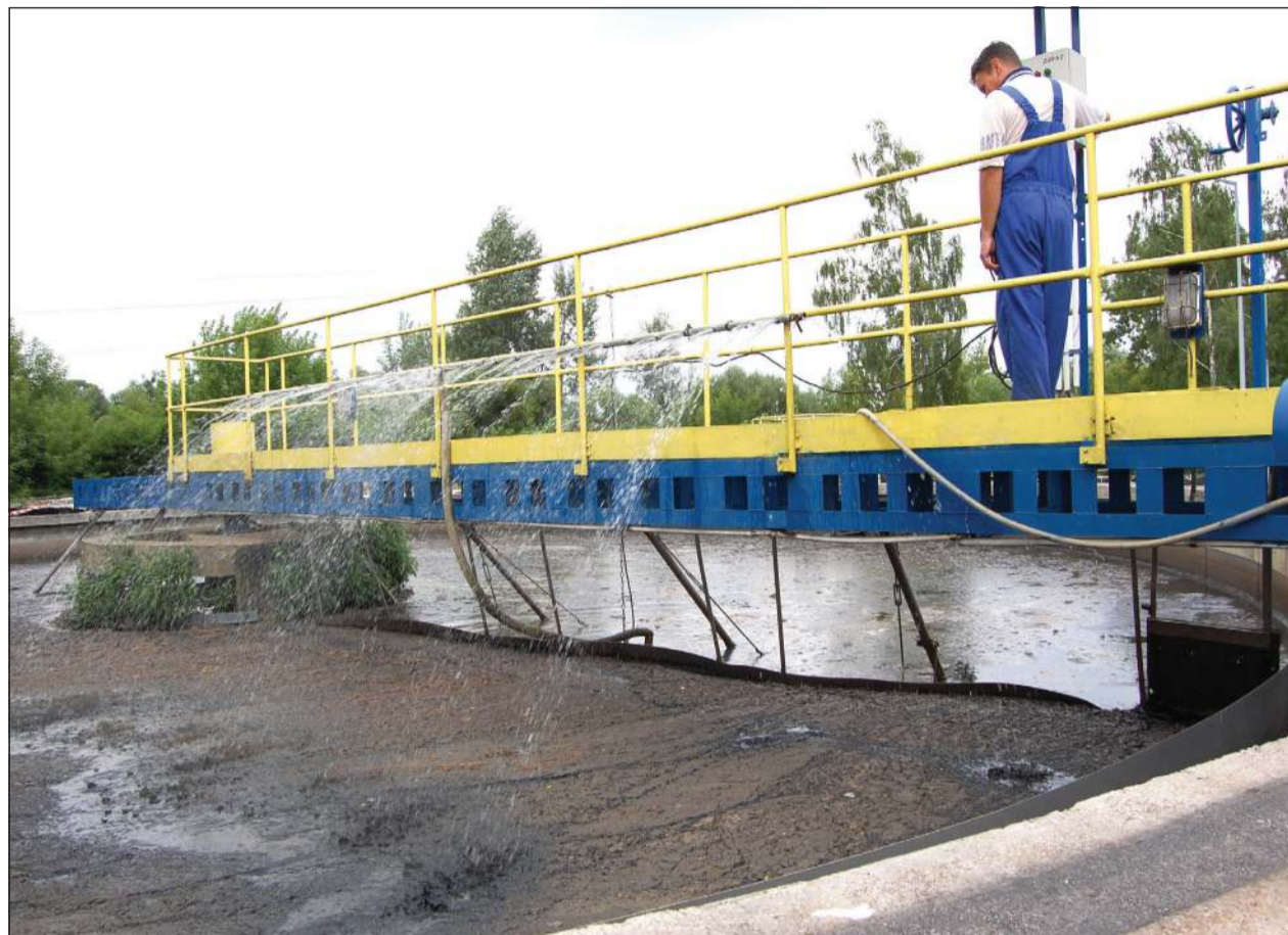
Równoległe z budową sieci sanitarnej z Chodakowa do Trojanowa twają prace modernizacyjne w obrębie oczyszczalni ścieków
