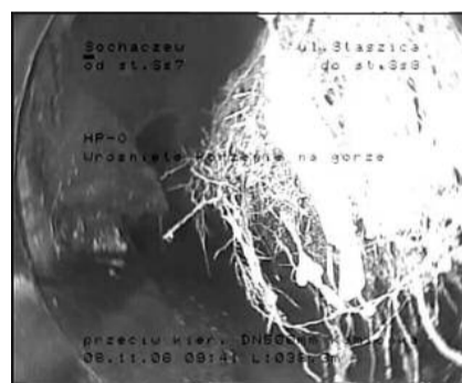
Widok z kamery - korzenie wewnątrz kanalizacji
