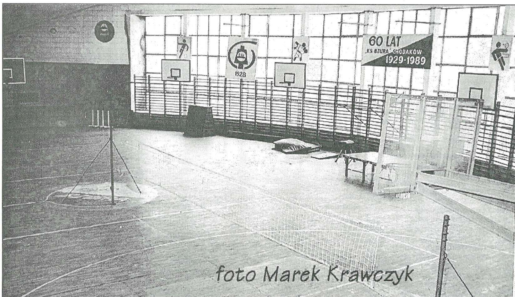
Hala sportowa w Chodakowie czeka na remont od wielu lat...
