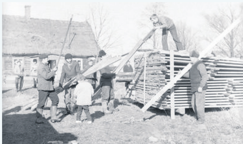
Budowa w czynie społecznym zlewni mleka w Matyldowie. Zdjęcie z zasobów Narodowego Archiwum Cyfrowego
